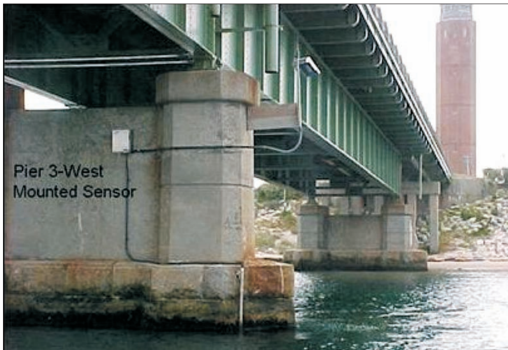
Rys. 7. Widok instalacji stałego sonaru monitorującego rozmycia dna przy filarze zawierającej stację zdalnej transmisji danych i ogniwo słoneczne; na filarze 3 widać zainstalowany rejestrator sonaru [13]
