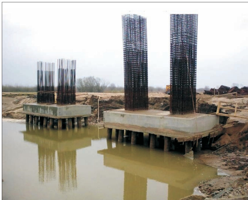
Rys. 1. Podmycie filarów wiaduktu dojazdowego do mostu przez Wisłę koło Grudziądza autostrady A1; wiadukt jest na terenie zalewowym, podmycie nastąpiło w czasie jego budowy w 2010 r.
