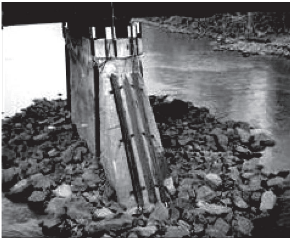
Rys. 8. Zainstalowane na ścianie filara obudowy dwóch stałych, zautomatyzowanych tyczek sondujących, które monitorują poziomy narzutu kamiennego [13]
