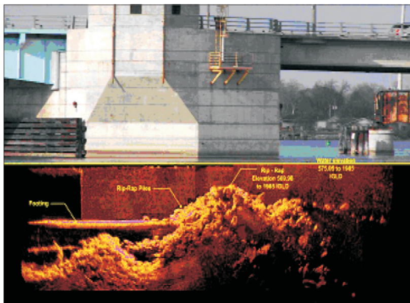
Rys. 16. Rezultat pionowej wizualizacji filaru mostu uzyskany sonarem skanującym ukazujący nieprawidłowe rozmieszczenie narzutu kamiennego (sonar skanujący) [8]
